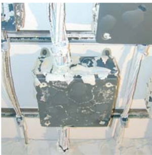
Kućiče s priključenim kablovima nakon testiranja.
